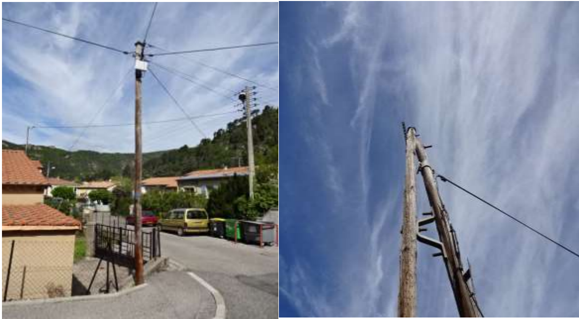
Annexe 3 : Photo d'un poteau FT
